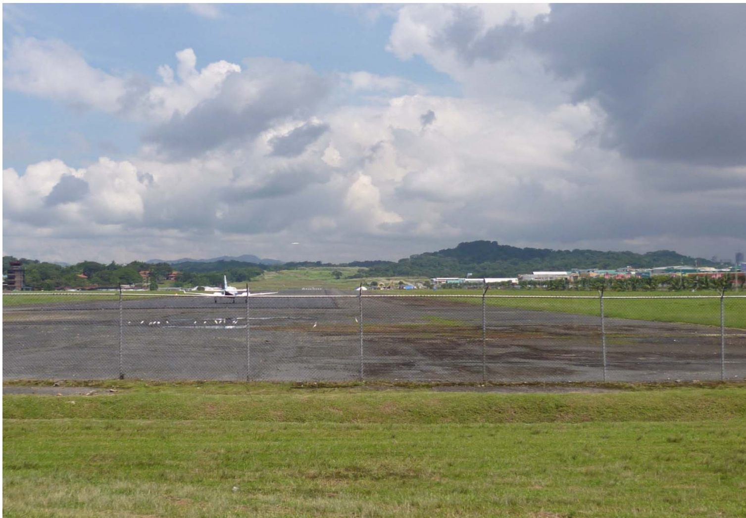
Acumulación o espejos de aguas pluviales, plataforma
